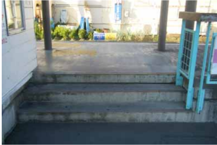
写真 別所線 駅 手すりなし
